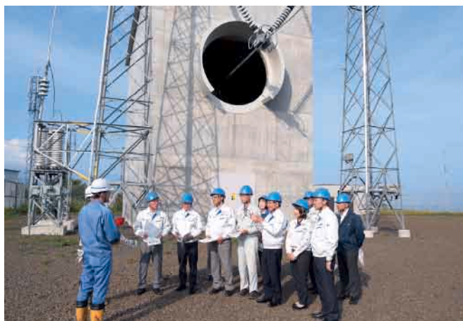
青函トンネル内のケーブルに繋ぐ吉岡ケーブルヘッド(福島町)
